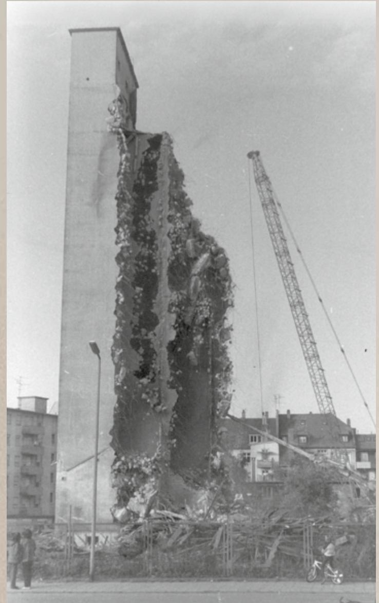
Einzig das Stahlgeflecht hält den Turm noch zusammen.
