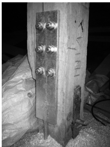
Bild 1.4 Maßstabsprengende „Reparatur“ eines völlig unbeschädigten historischen Anschlusses.
