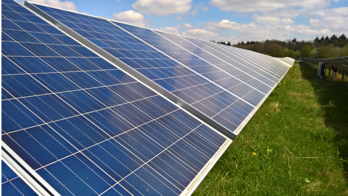
Bild 7.1 PV-Generator einer Freiflächenanlage
