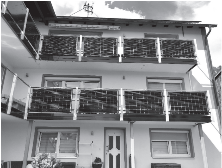
Abbildung 1.1: Mehrere Balkonkraftwerke (Copyright: Solarwatt)
