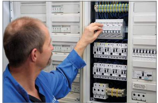
Bild 1: Verteilerschrank einer Elektroinstallation mit Schutzschaltern www.siemens.com
