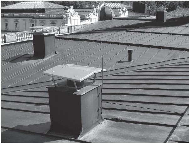
Fangstange als Teil des äußeren Blitzschutzes auf einem denkmalgeschützten Gebäude
